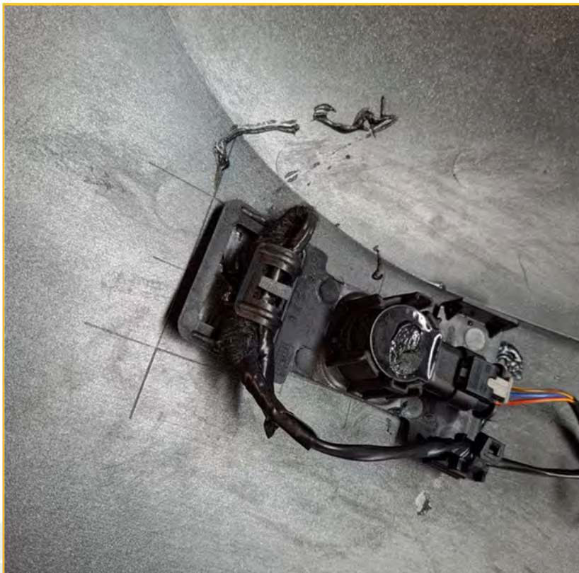
Bild 4: Kabelende im Nassbereich gesichert (keine Geräusentwicklung)
