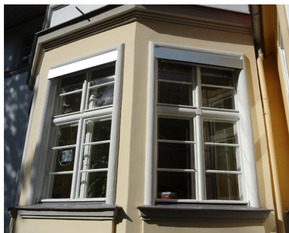
Bild 4: Altbeschichtungen auf Holzfenstern können Bleiweiß enthalten
