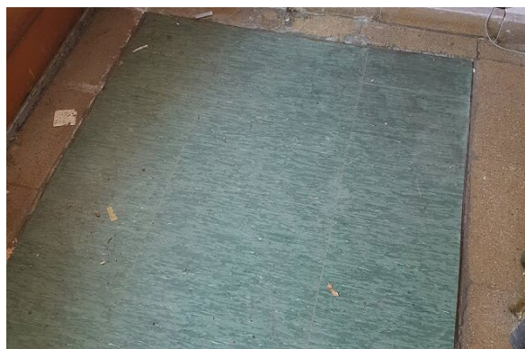
Bild 2: asbesthaltiger „Cushion-Vinyl“ (CV)-Belag
