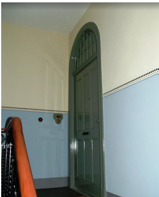
Bild 11: Alte Sockelbeschichtung z. B. in Treppenhäusern können PCB-haltig sein (Symbolbild)
