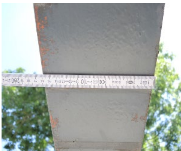
Bild 3: orangefarbene bleihaltige Korrosionsschutzgrundbeschichtung auf einem Stahlträger
