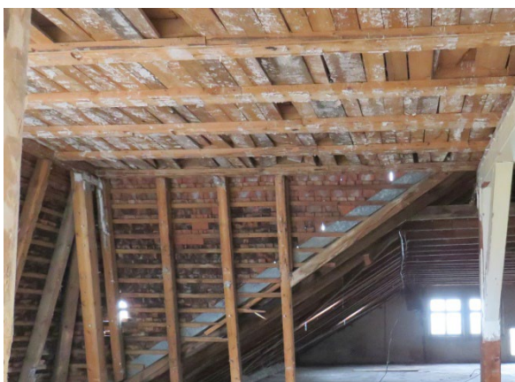
Bild 12: Holzschutzmittel im Dachstuhl
